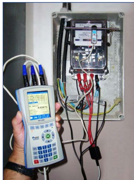
Kontrola elektromera u zákazníka
